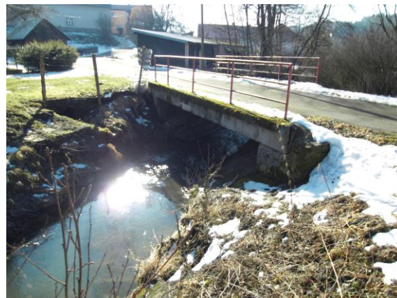
Poškozený most na Podpolí
